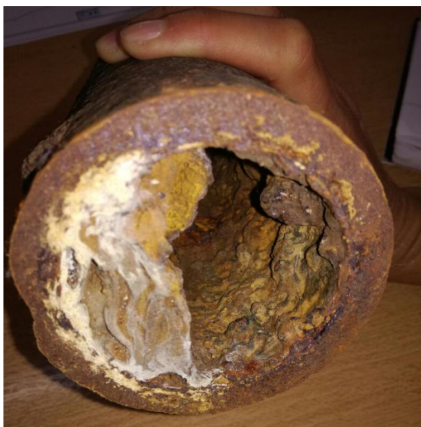
Figura 155. Estado de la red de agua potable en Ciudad de Mendoza.
